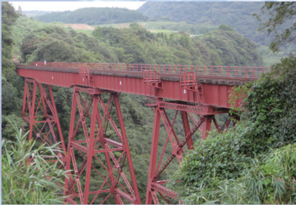
南阿蘇鉄道・立野橋梁他18橋梁(熊本県阿蘇郡)
